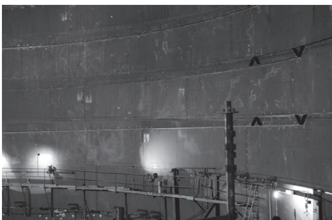
Rys. 9. Charakterystyczne łączenie usztywniających pierścieni obwodowych wraz z „mijanką” spoin ułożonych spiralnie (fot. firma Midroc Rodoverken AS)
